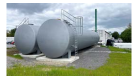
Nádrže na biodiesel o velikosti 250 m 3
